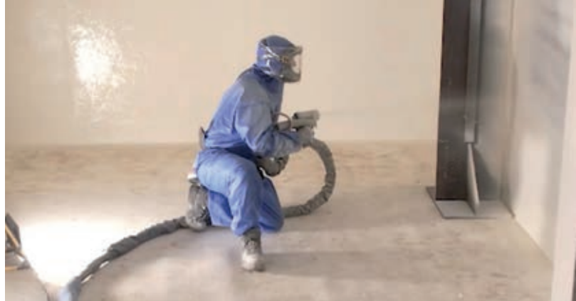
Aanbrengen van poly-urea spuitcoatings om ruimtes vloeistofdicht te maken / Application de revêtements par pulvérisation de polyurée pour rendre les espaces imperméables aux liquides
